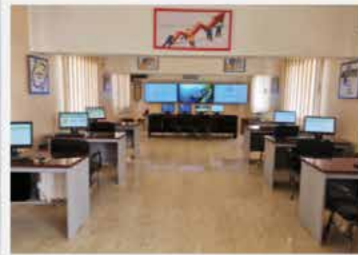
صالة التشغيل لمركز البيانات
